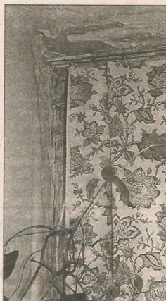
Przeciekająca elewacja w jednym z pokoi komendy
