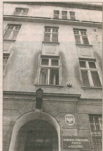
Ciemniejsze ślady przy oknach to zabezpieczone miejsca, skąd tynk całymi płatami odpadał na chodnik
